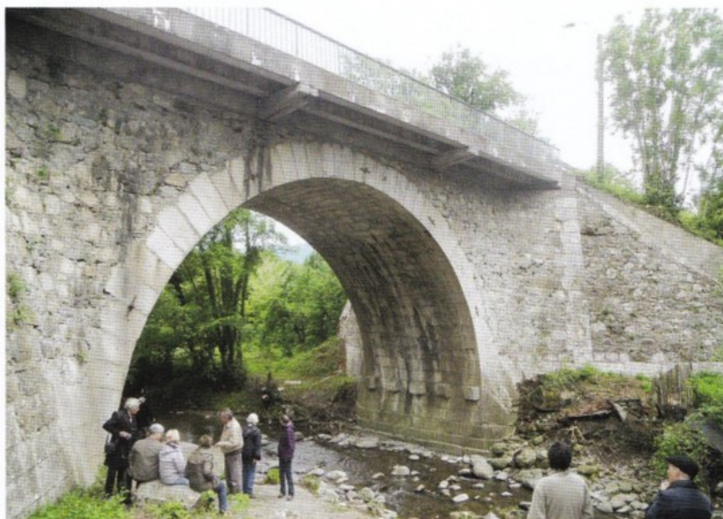
Le pont avant sa destruction.
