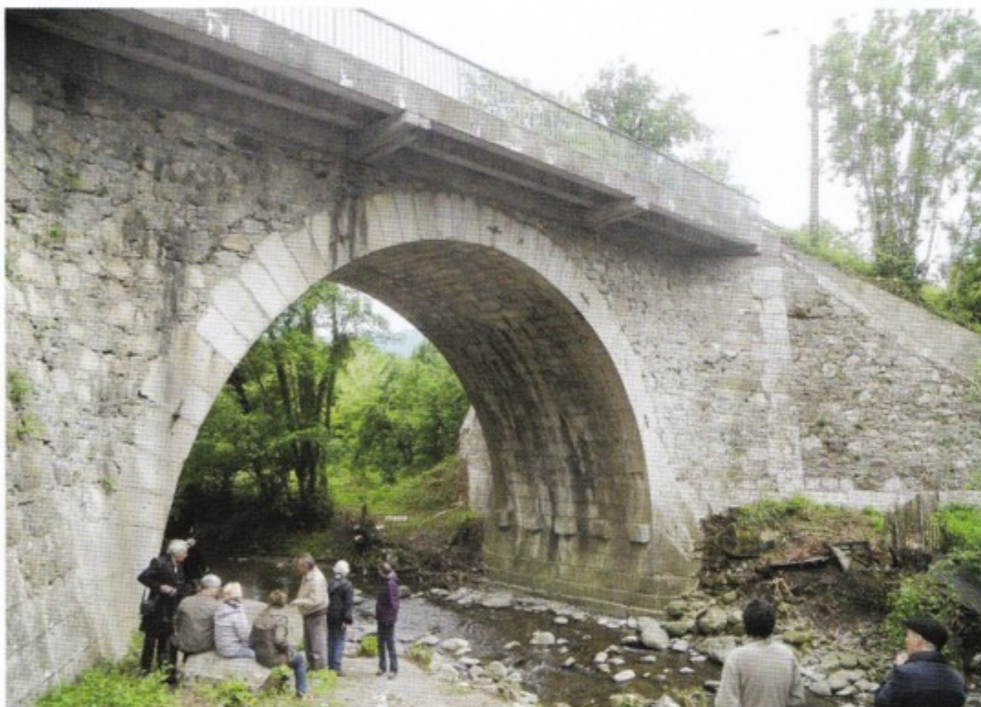
Le pont avant sa destruction.
