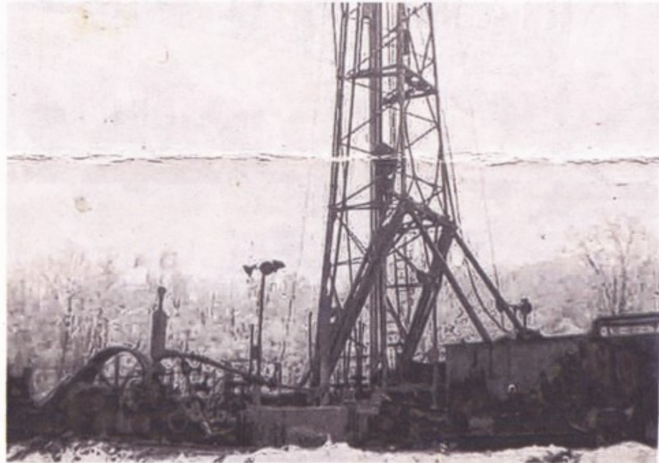
Un cliché rare du derrick installé à Bellossy pour forer le sous-sol à la recherche de traces de pétrole.
