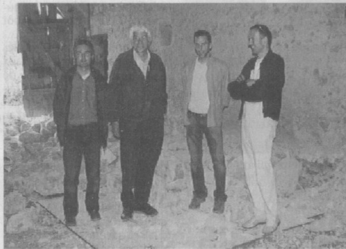
L'intérieur du bâtiment en plein chantier, avec Éric Dürr, Alain Bullat et Frédéric Dumoulié (SMS), en compagnie de l'architecte Philippe Guyard.
